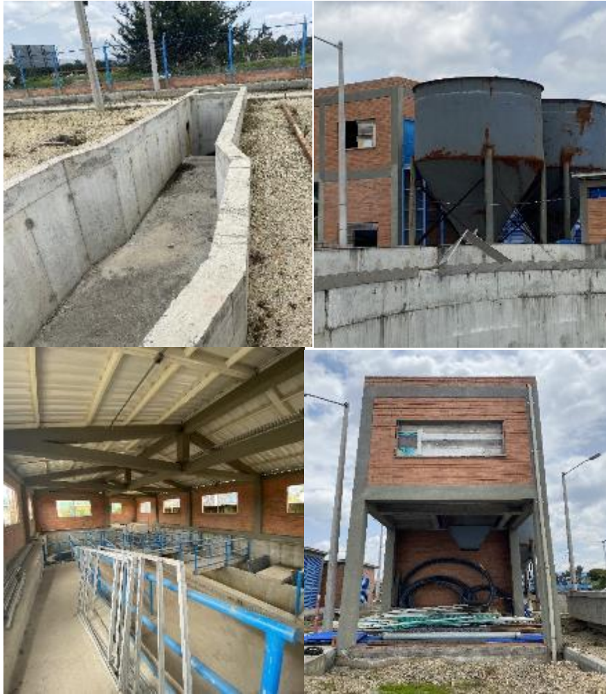
Fotos: CGR- Planta de Tratamiento de Aguas Residuales de Cota- marzo 2023.
