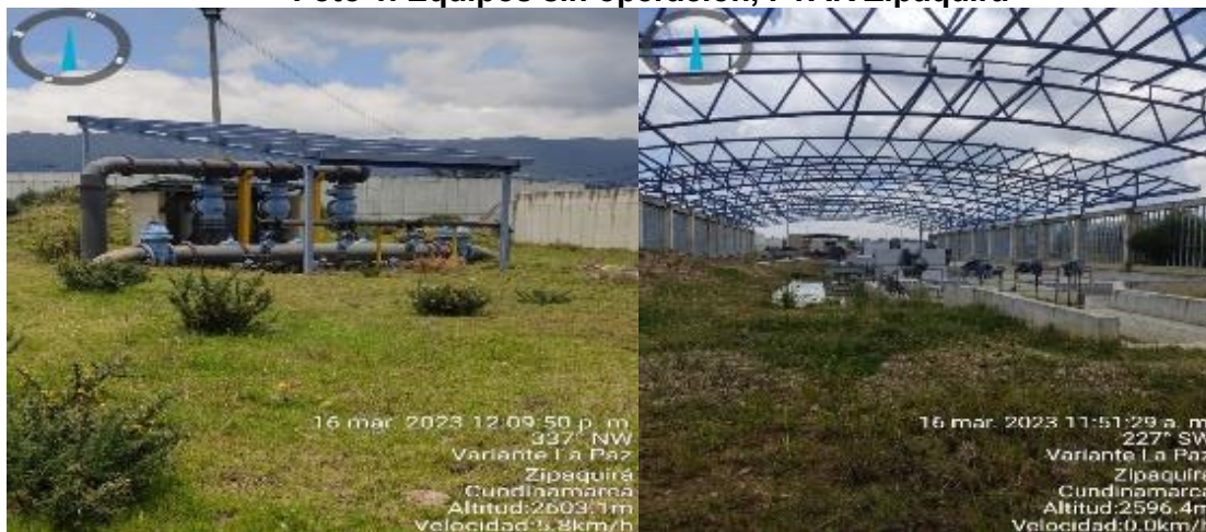
Foto 1. Equipos sin operación, PTAR Zipaquirá
